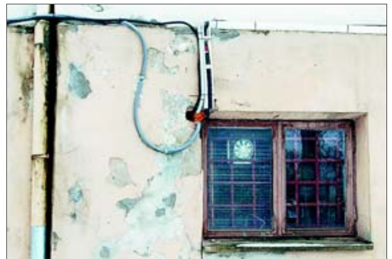
VISKAS PASENĖ. Muziejaus sienos trupa ir skilinėja, o elektros instaliacija - visiškai susidėvėjusi ir neatlaiko elektros energijos apkrovų.
